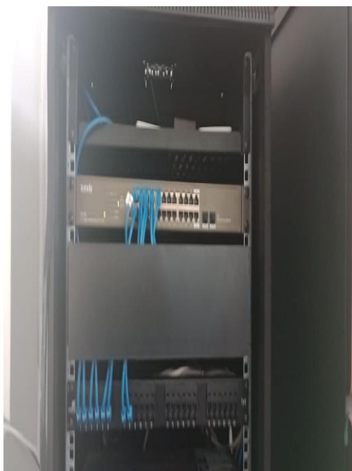
Ilustración 3. Organizador de cables instalado
