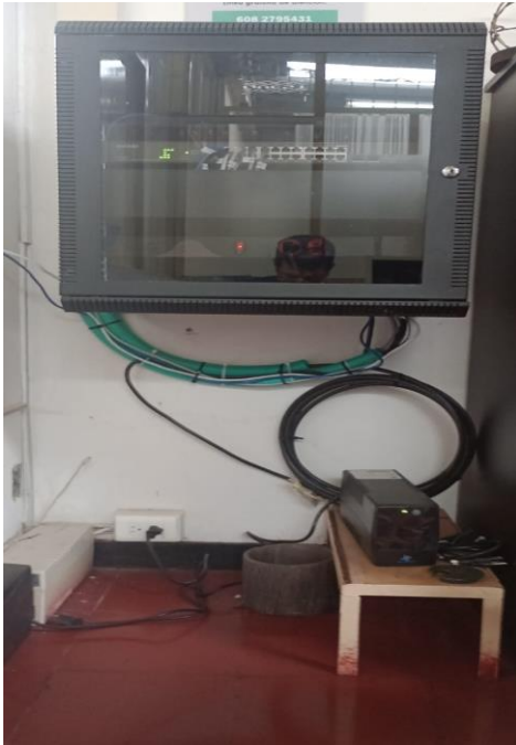
Ilustración 5. Visualización externa del rack después.
