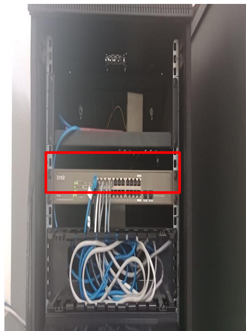
Ilustración 2. Switch 24 puertos Gigabit instalado.
