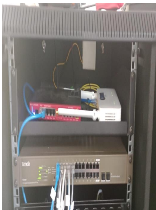
Ilustración 4. Maquillado de cableado.
