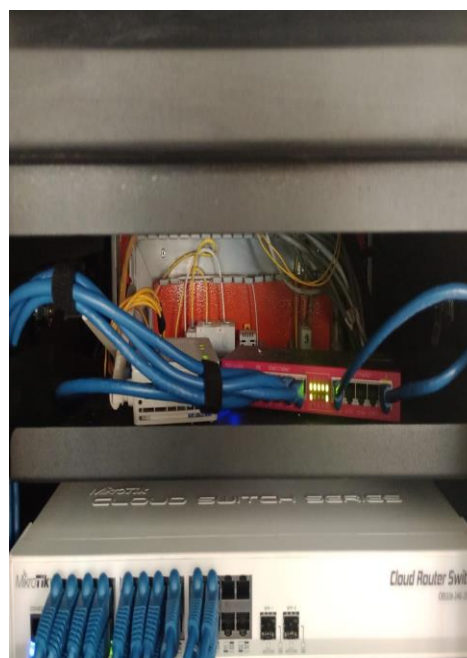
Ilustración 7. RouterBoard en el nuevo DATA CENTER.
