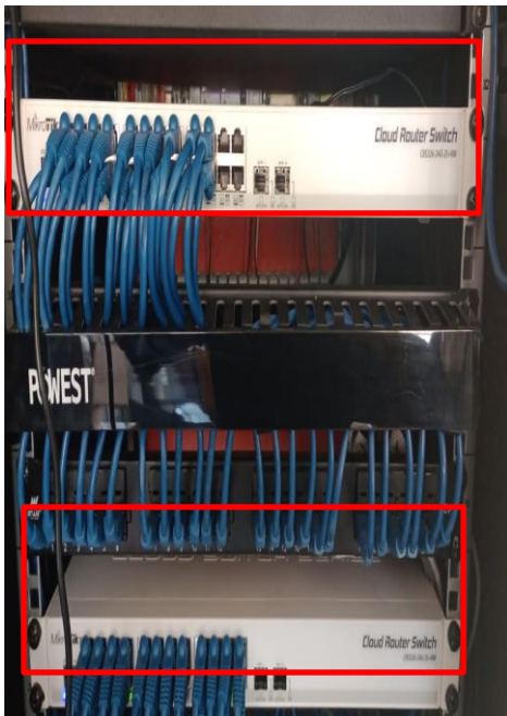
Ilustración 6. Los dos Switches 24 puertos instalados
