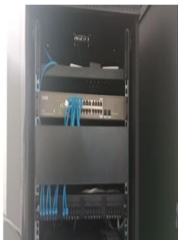
Ilustración 3. Organizador de cables instalado
