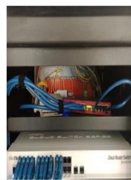
Ilustración 7. RouterBoard en el nuevo DATA CENTER.
