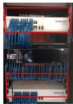
Ilustración 6. Los dos Switches 24 puertos instalados
