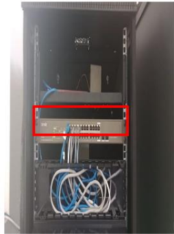
Ilustración 2. Switch 24 puertos Gigabit instalado.
