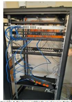
Ilustración 4. Equipos y cableado en el nuevo Data Center
