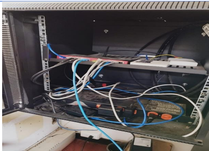
Ilustración 2. Vista general del Rack
