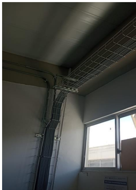
Ilustración 2. Ruta de cableado
