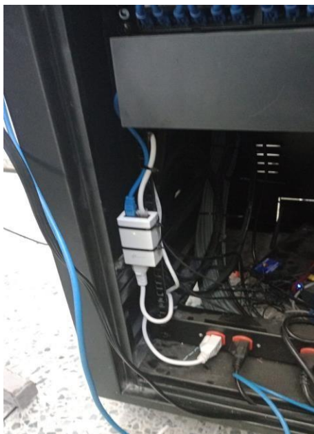
Ilustración 1. Verificando dispositivos del rack principal
