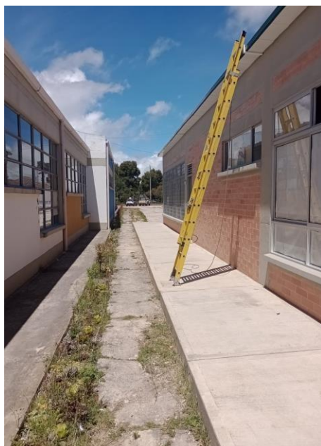
Ilustración 3. Ruta de cableado
