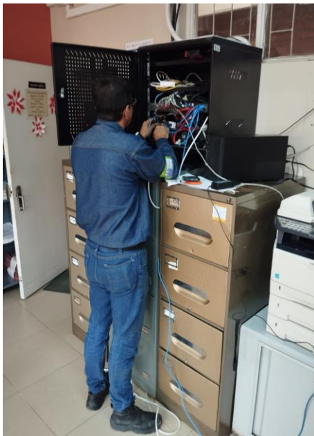
Ilustración 1. Verificando dispositivos del rack principal
