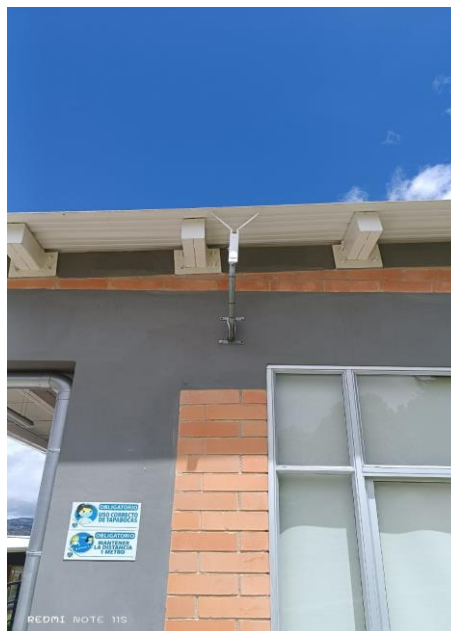
Ilustración 2. Equipo doble banda instalado
