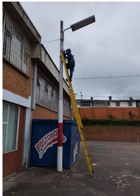
Ilustración 2. Instalación equipo doble banda
