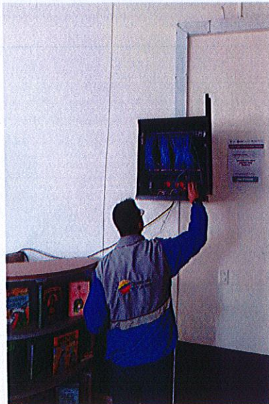
Ilustración 4. Verificando dispositivos del rack principal
