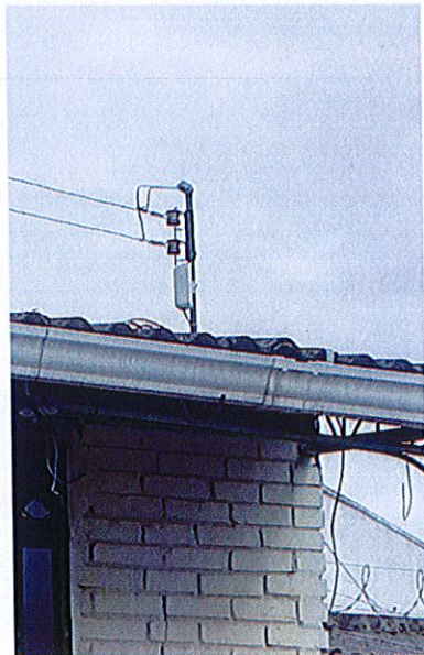
Ilustración 1. Zona Wifi Instalada
